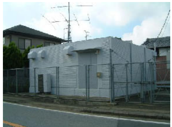
施主：通信基地局 安孫子市キューピクル
